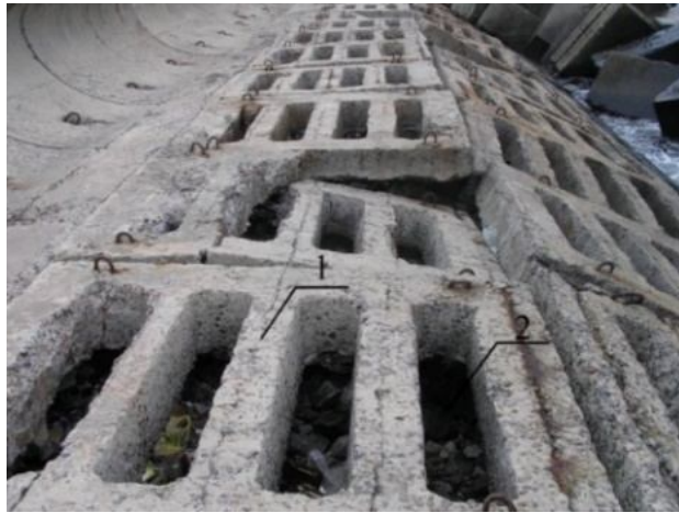
Рис. 8. Руйнування укосу укріпленого решітчастими плитами
