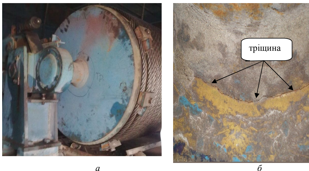
Рис. 1. Вигляд фронтальної частини вантажної лебідки портального крана (а) і тріщина у стіні корпусу лебідки (б) після 35 років експлуатації
