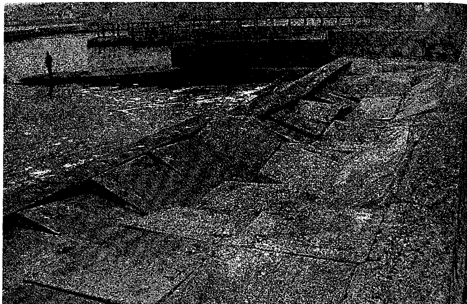
Рис. 8. Требуется ремонт покрытия, рядом на плато расположены монастырь и духовная семинария. Духовным лицам и прихожанам тоже не мешает в нормальных условиях окунуться в море
