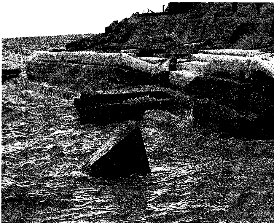
Рис. 5. Требуется капитальный ремонт неудачной конструкции, море наглядно подтвердило это
