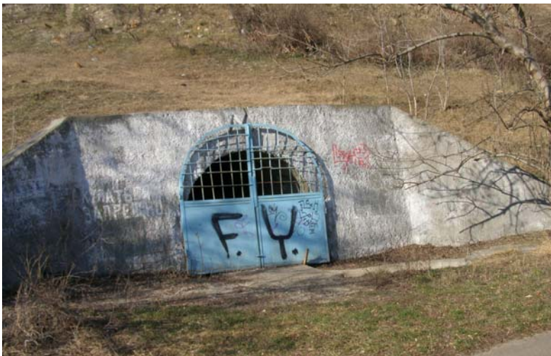
Рис. 2. Вывод подземных вод из дренажной галереи
