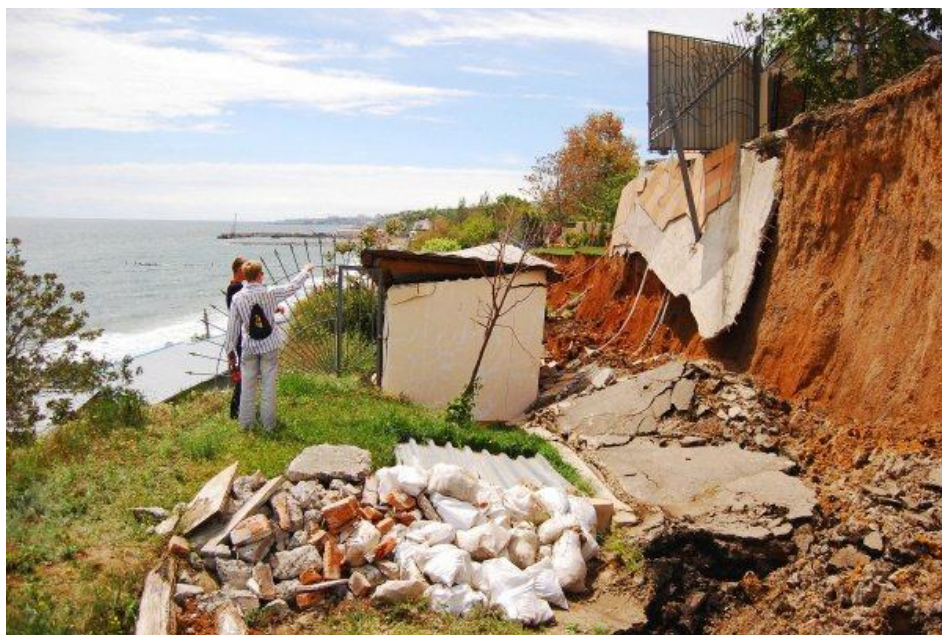
Рис. 8. Оползень на неблагоустроенном склоне
