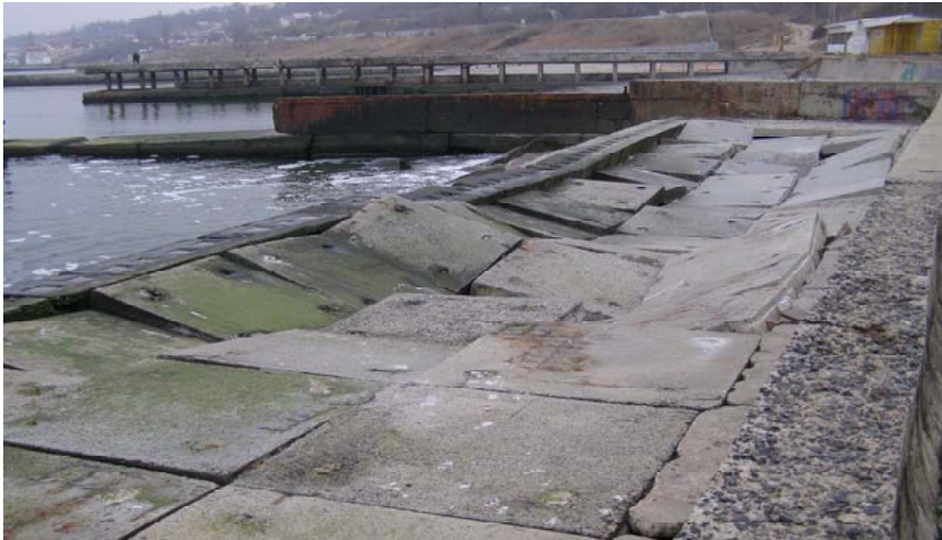
Рис. 3. Повреждение плит покрытия откоса
