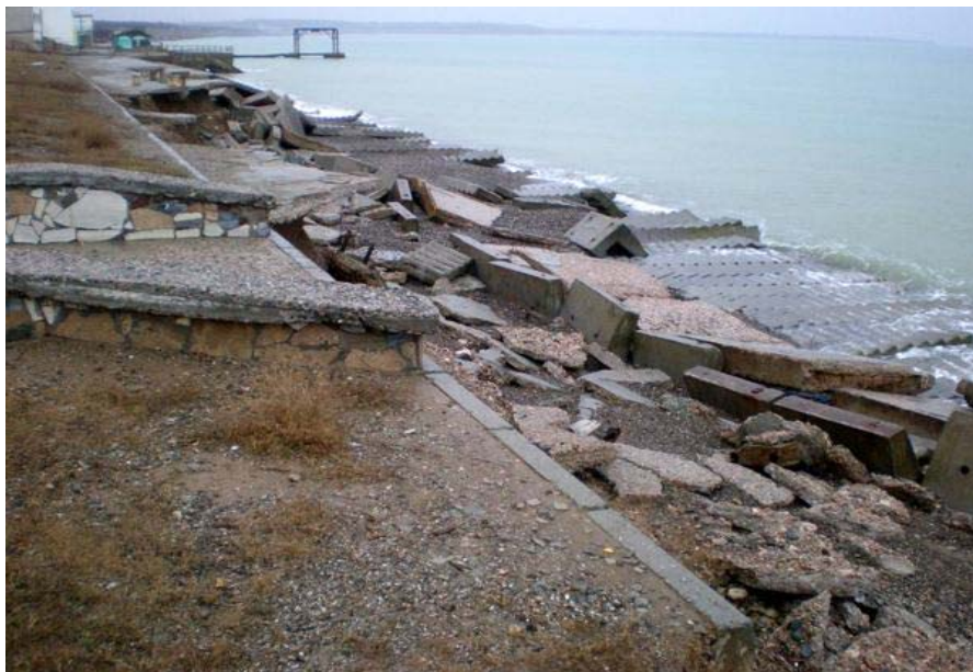
Рис. 2. Разрушение берегозащитных сооружений от штормовых волн
