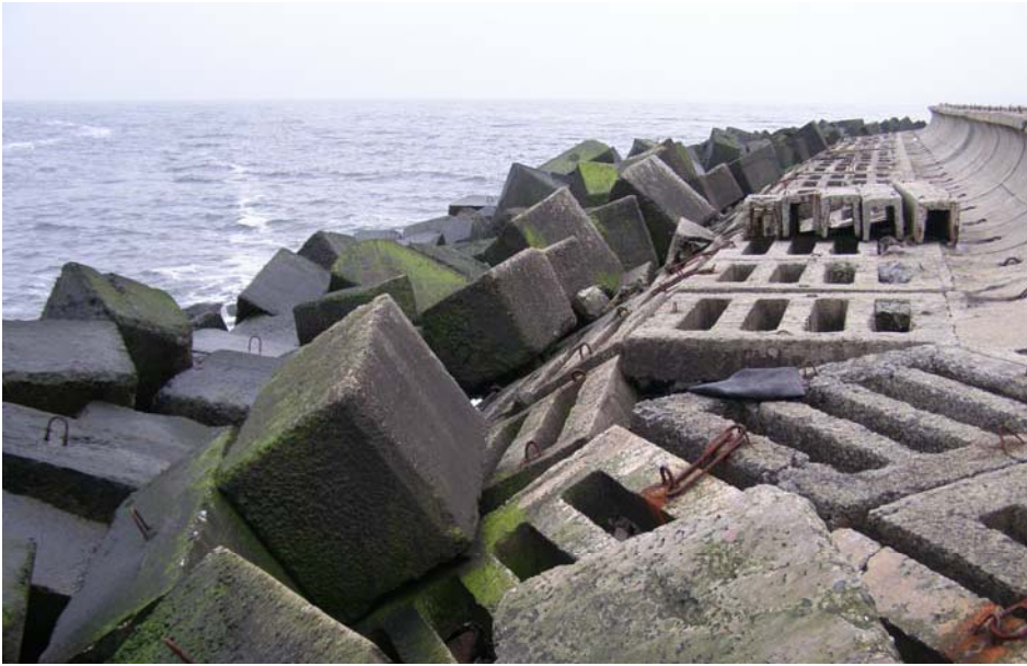
Рис. 1. Берегозащита бетонными массивами
