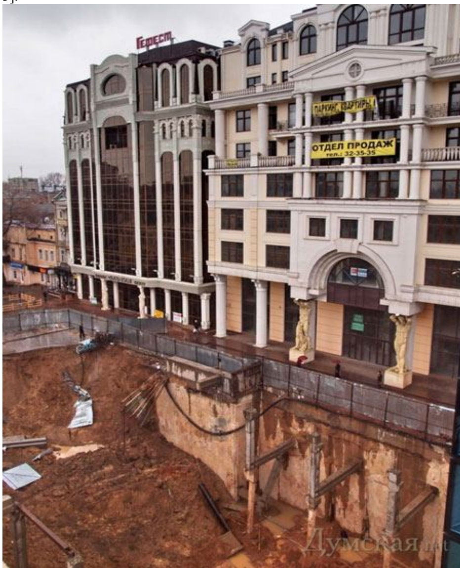
Рис. 5. Обрушение стенок котлована на Греческой площади в Одессе
