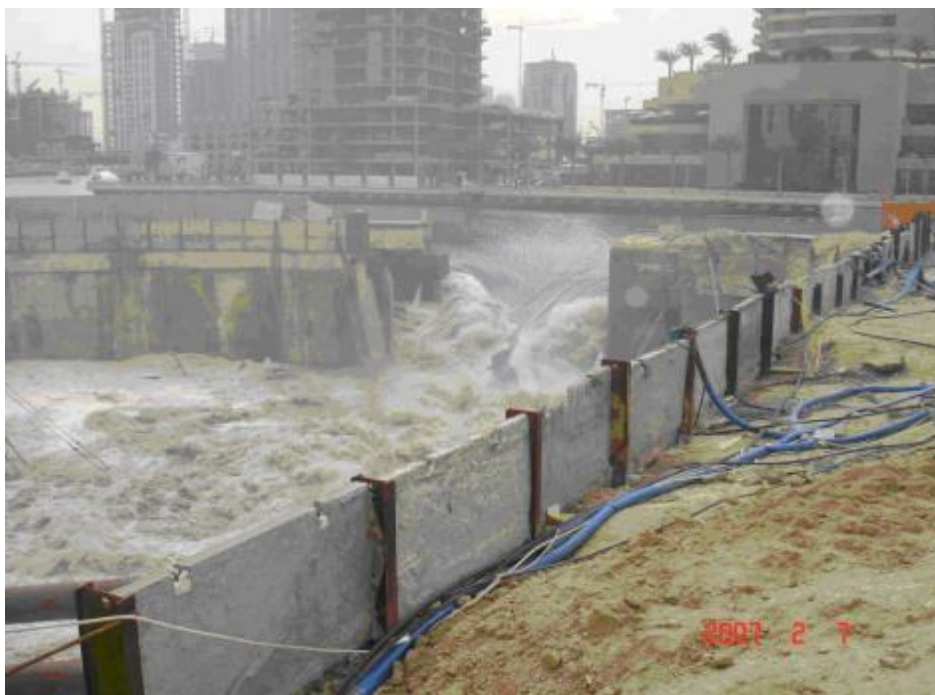
Рис. 6. Обрушение котлована в Загребе в 2007 г.
